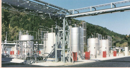
プラント設備（危険物貯蔵所）
