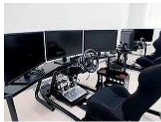
管制・遠隔運転室
